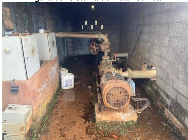
Figura 08: Sistema de motor-bomba.
